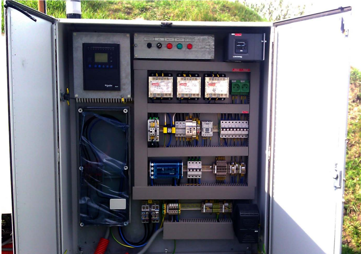
Een ontkeppelbord voor kleine windturbines met voorziening voor groenestroommeter
